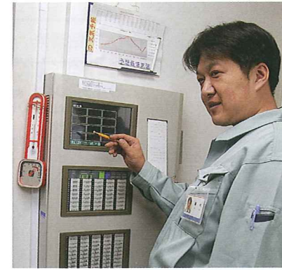
ボイラー室。管理会社には設計者の意図に沿って設備をうまく運転していくことが求められる。テナントとの対話に基づき細かい運転の工夫により、大きな省エネ効果が得られる
